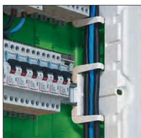
6 OŽIČENJE Integrirani bočni vodiči za kabele
